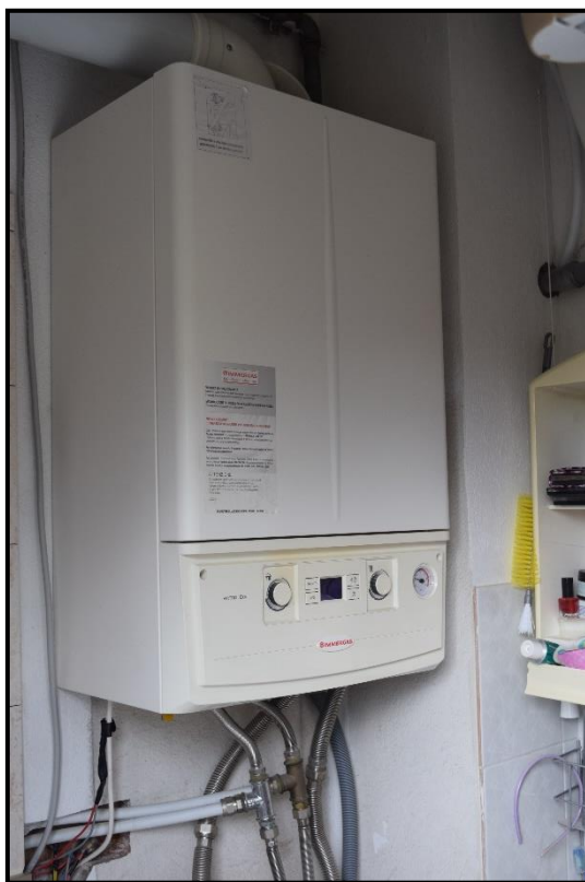
LOTTO 001- Corpo B - FOTO 28 – NICOSIA - Foglio 83 - Particella 1260 - Sub. 3 – Generatore termico a servizio dell'appartamento
