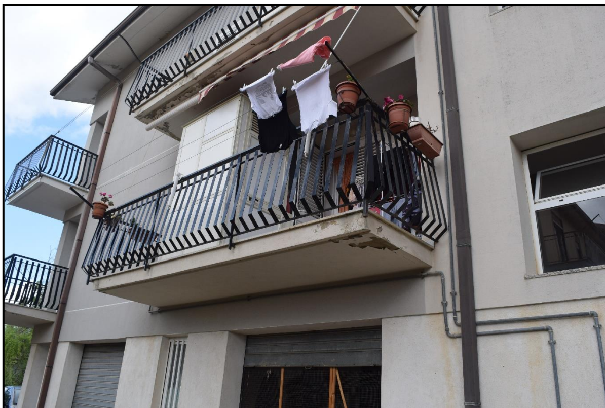
LOTTO 001- Corpo B - FOTO 33 – NICOSIA - Foglio 83 - Particela 1260 - Sub. 3 – Dettaglio dei frontalini ammalorati dei ballatoi
