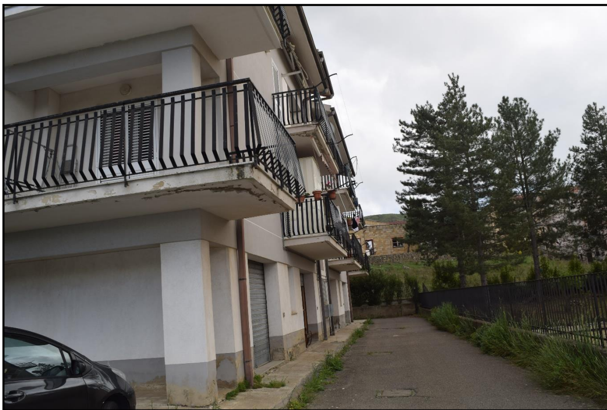
LOTTO 001- Corpo B - FOTO 32 – NICOSIA - Foglio 83 - Particela 1260 - Sub. 3 – Dettaglio dei frontalini ammalorati dei ballatoi
