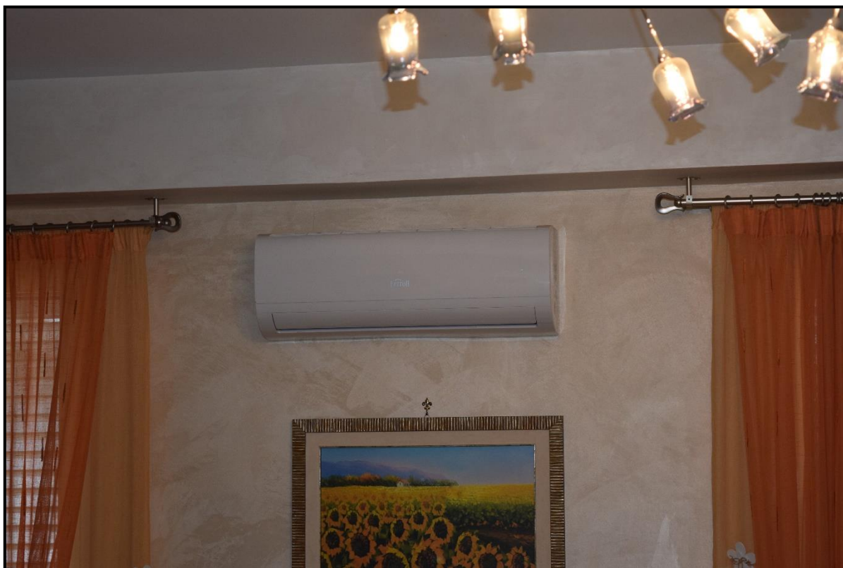
LOTTO 001- Corpo B - FOTO 30 – NICOSIA - Foglio 83 - Particela 1260 - Sub. 3 – Spit della pompa di calore del soggiorno
