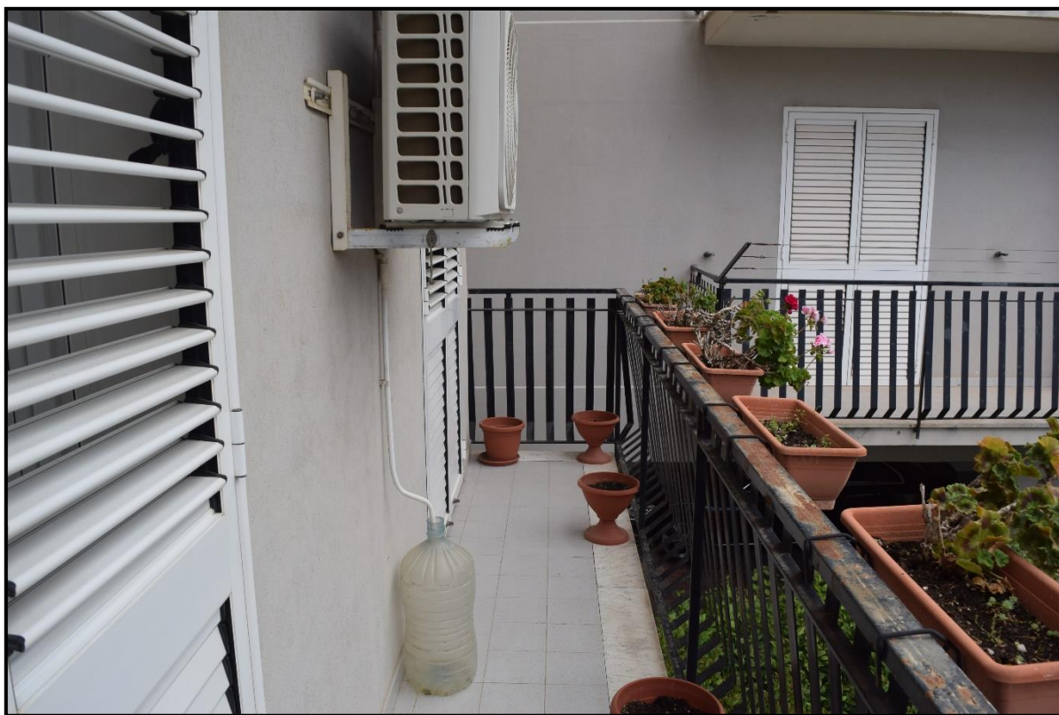
LOTTO 001- Corpo B - FOTO 26 – NICOSIA - Foglio 83 - Particela 1260 - Sub. 3 – Ballatoio vano soggiorno
