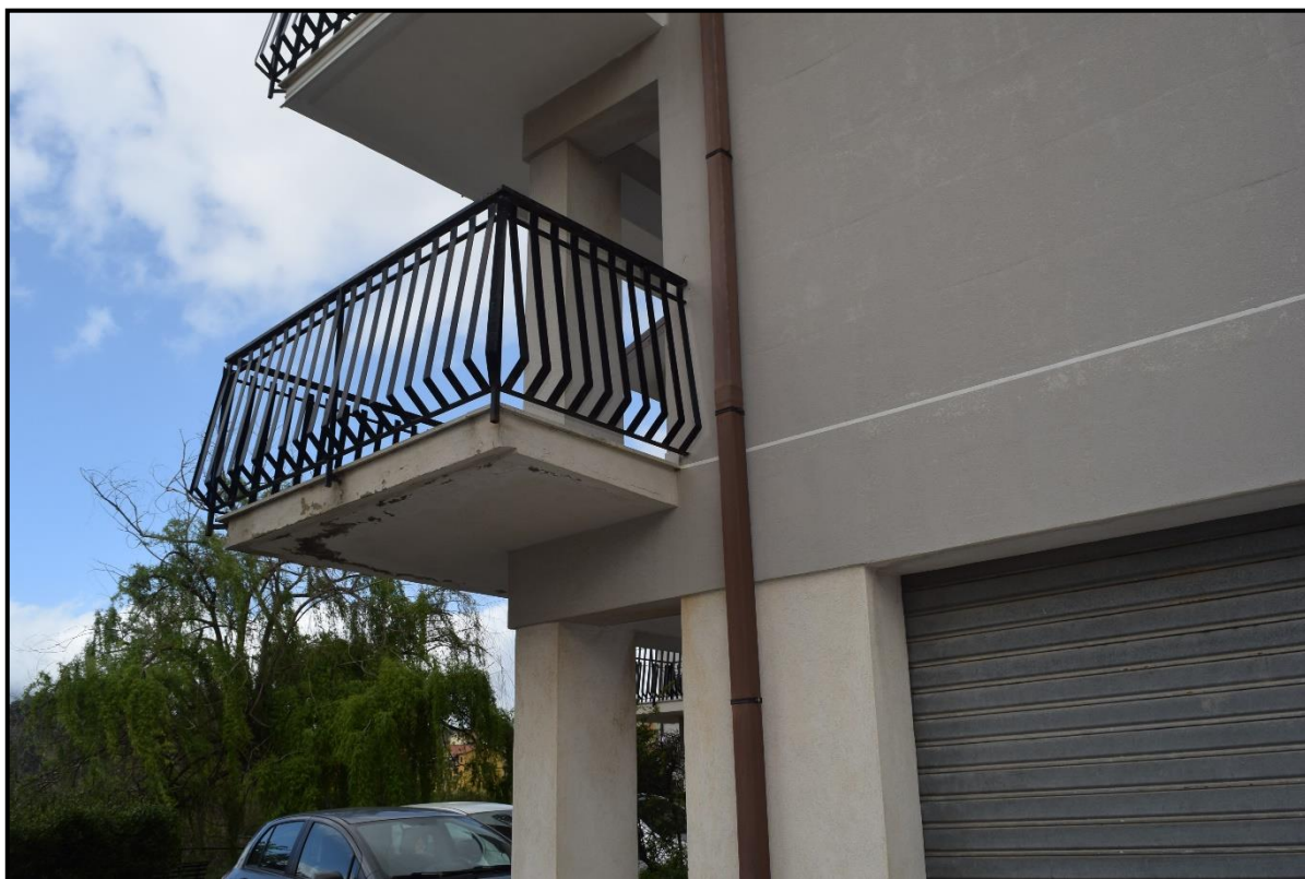
LOTTO 001- Corpo B - FOTO 31 – NICOSIA - Foglio 83 - Particela 1260 - Sub. 3 – Dettaglio dei frontalini ammalorati dei ballatoi
